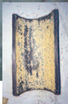
Eine Leitung mit hartnäckigen Ablagerungen.
