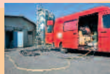
La pompe à eau est située dans le véhicule de nettoyage des silos.
