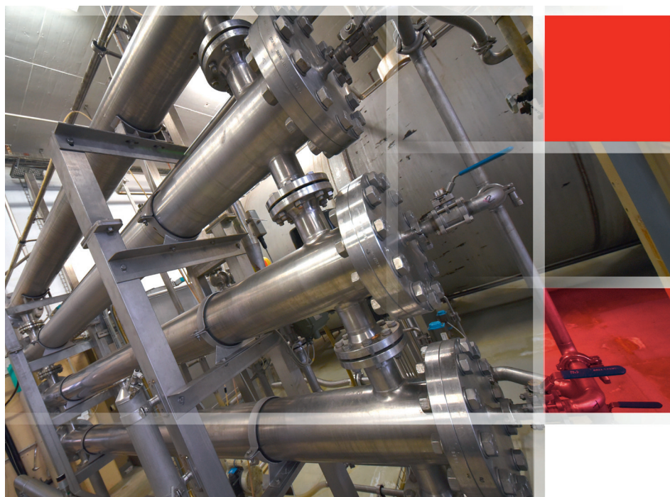
Die RO-Anlage, zum Eindicken von Molke, arbeitet seit der Optimierung durch Halag Chemie so gut wie am ersten Tag
